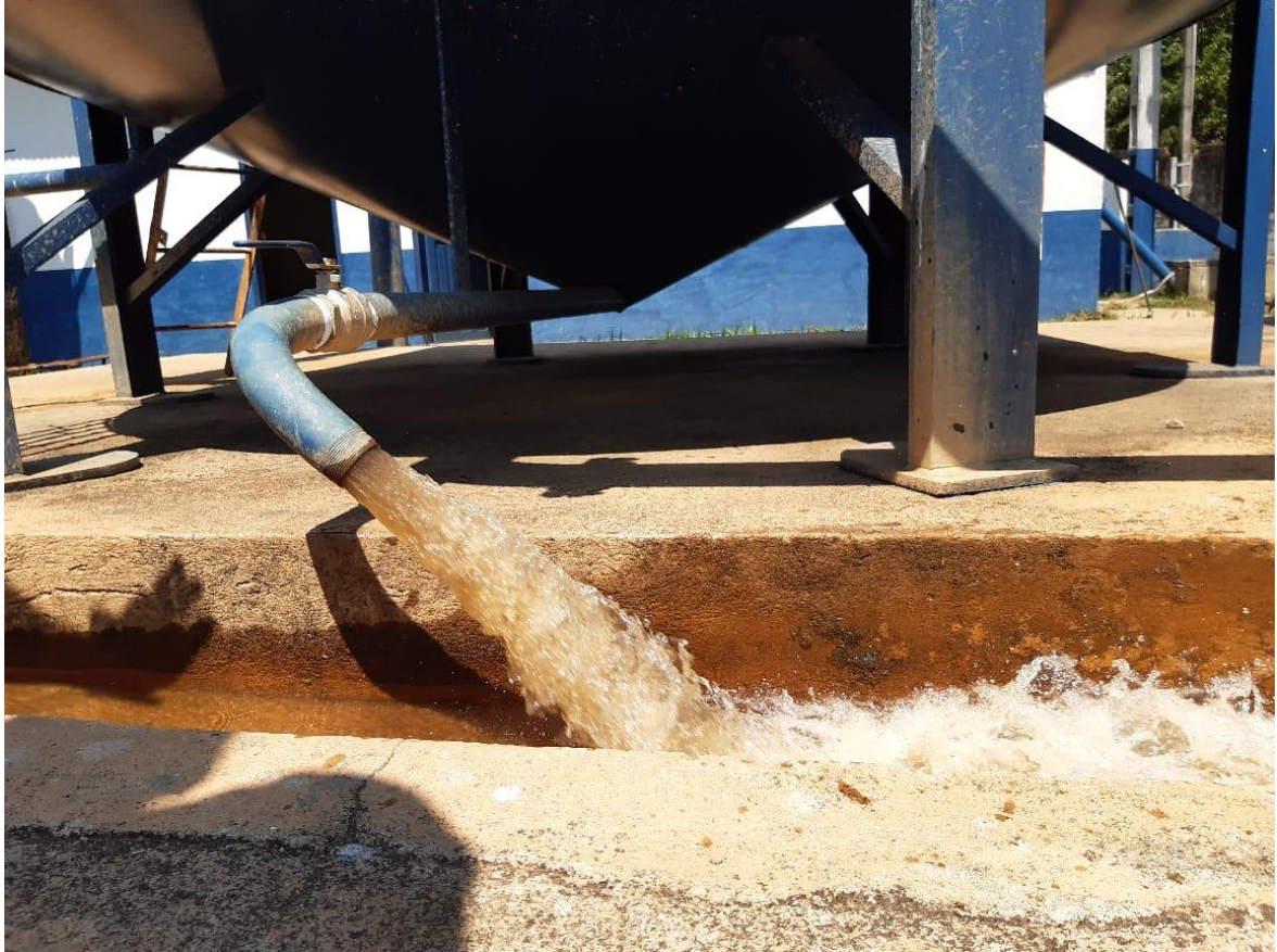
Figura 54 — Descarga do lodo de fundo.
