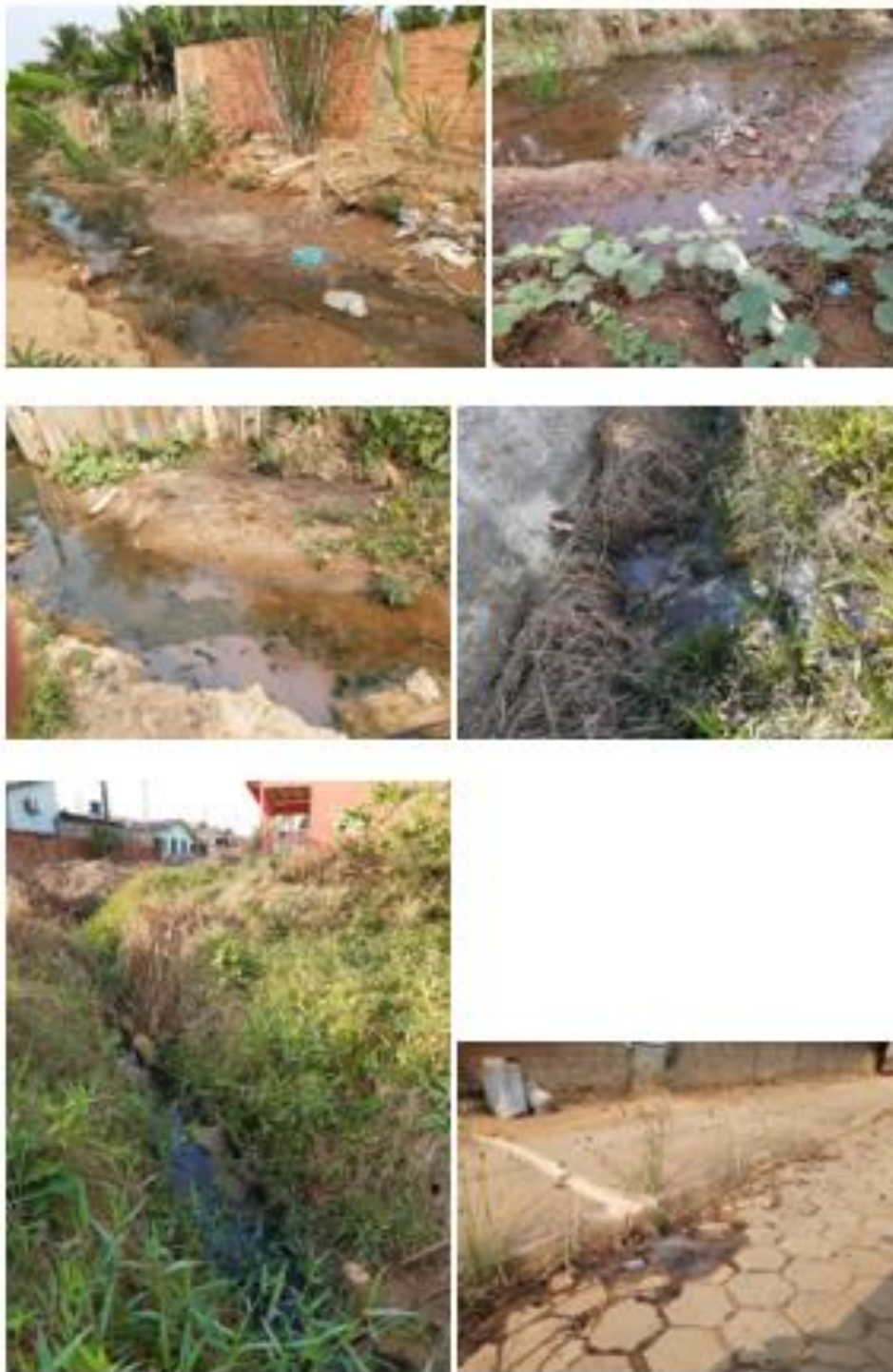
Figura 95 — Lançamento de esgoto para igarapé a céu aberto.
