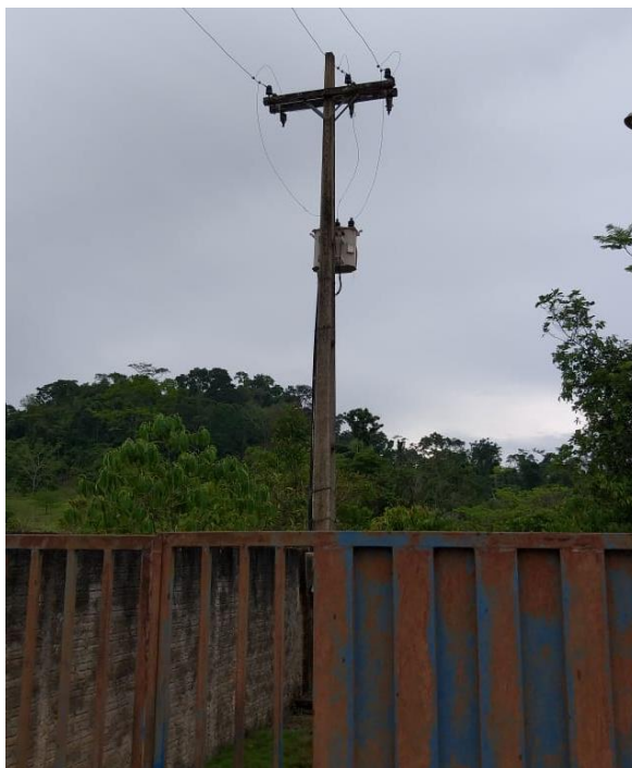
Figura 46 – Transformador da subestação.
