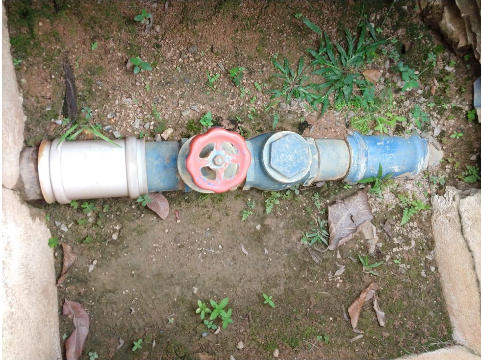
Figura 44 – Válvula de retenção e registro de gaveta.
