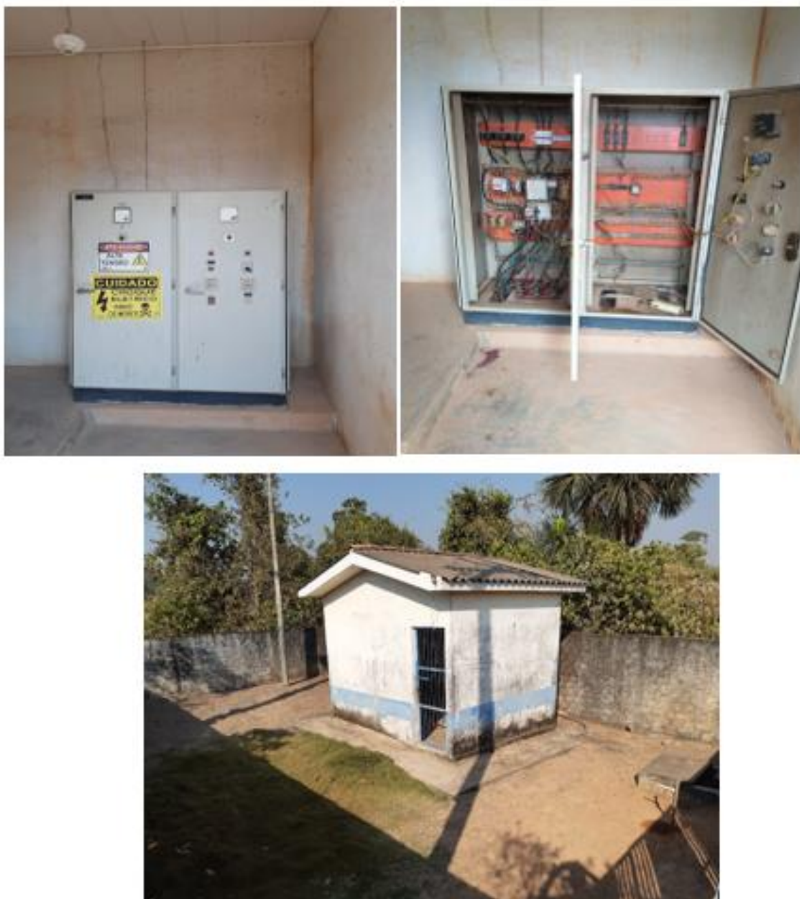
Figura 45 - Vista externa do painel de comando, vista interna do painel de comando e abrigo do conjunto motobomba
