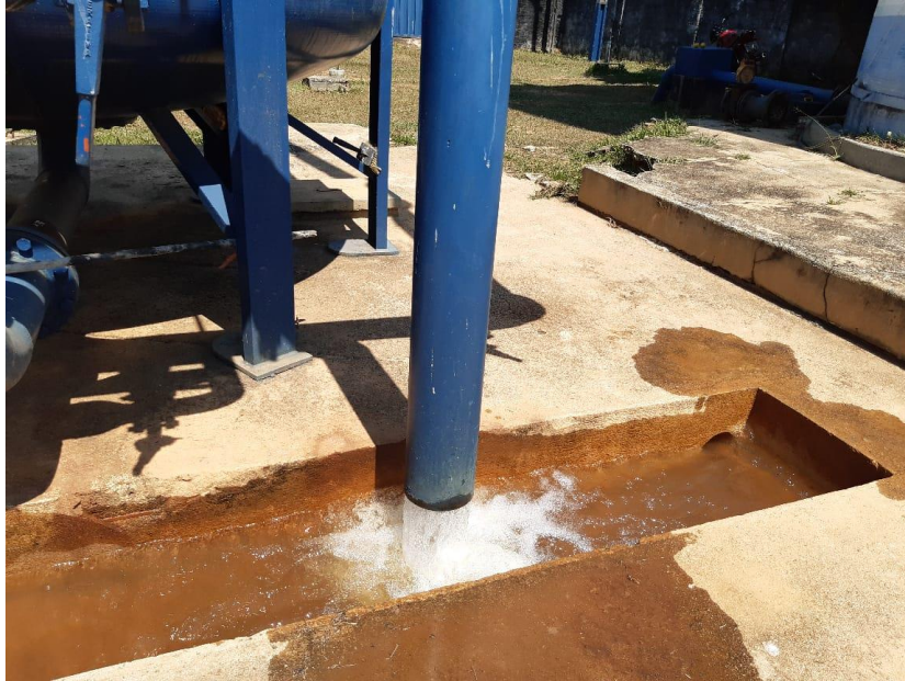
Figura 56 — Água oriunda da lavagem do filtro.
