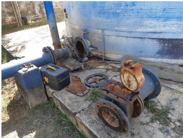
Figura 67 – Problema encontrado no reservatório elevado.
