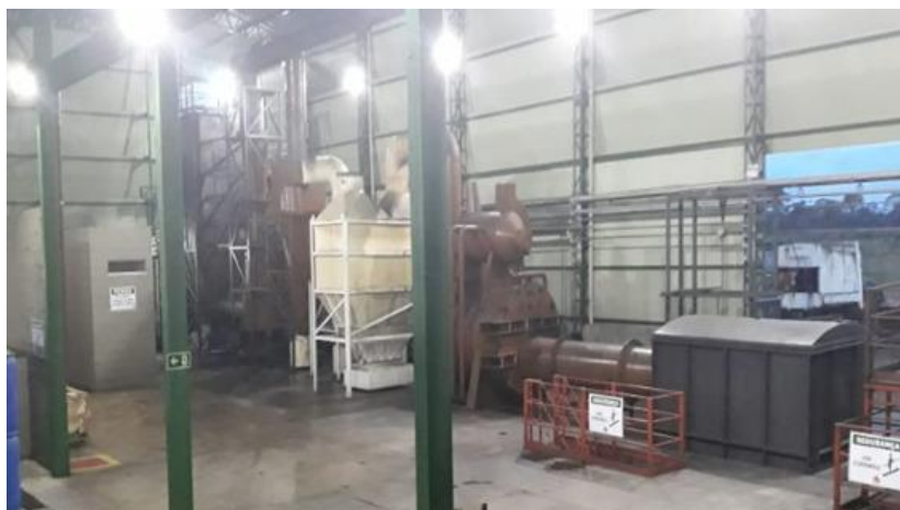
Figura 149 – Incinerador utilizado queima dos RSS
