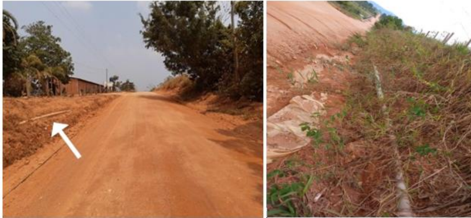
Figura 47 - Adutora com problema de afloramento.
