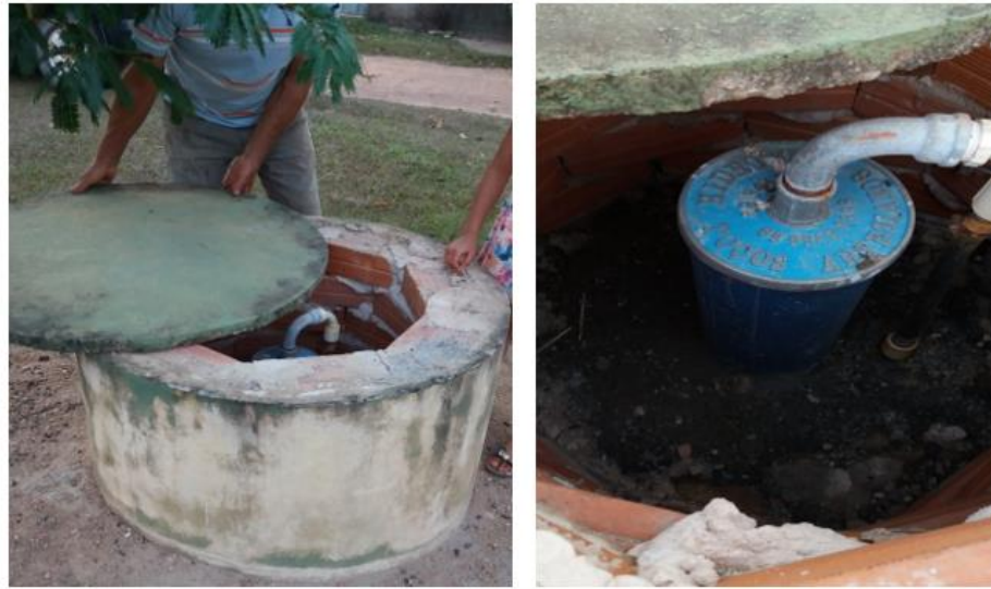
Figura 26 - Poço artesiano na área urbana
