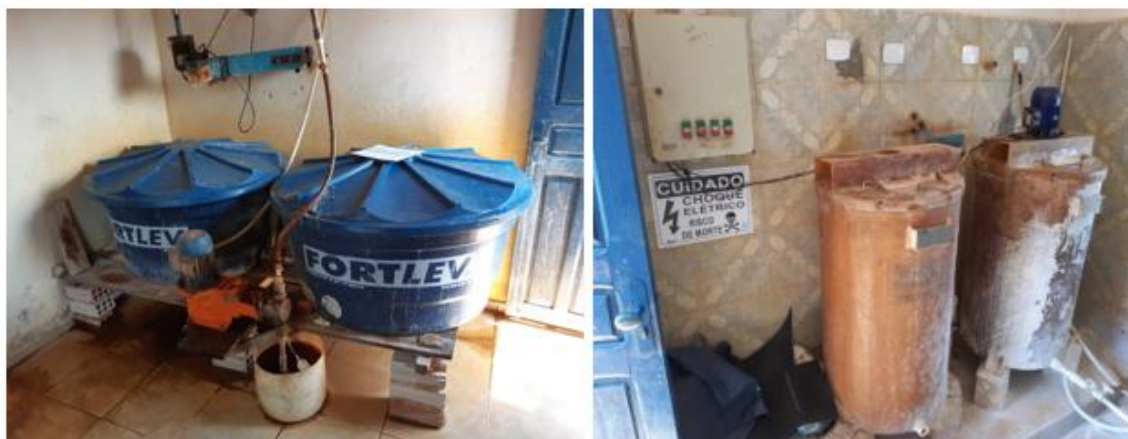
Figura 59 - bombas dosadoras e tanques de diluição de sulfato de alumínio e hipoclorito de cálcio.
