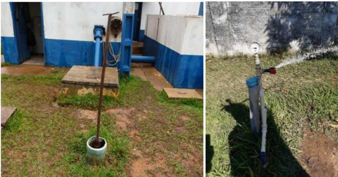
Figura 65- Vista da saída de recalque e manômetro
