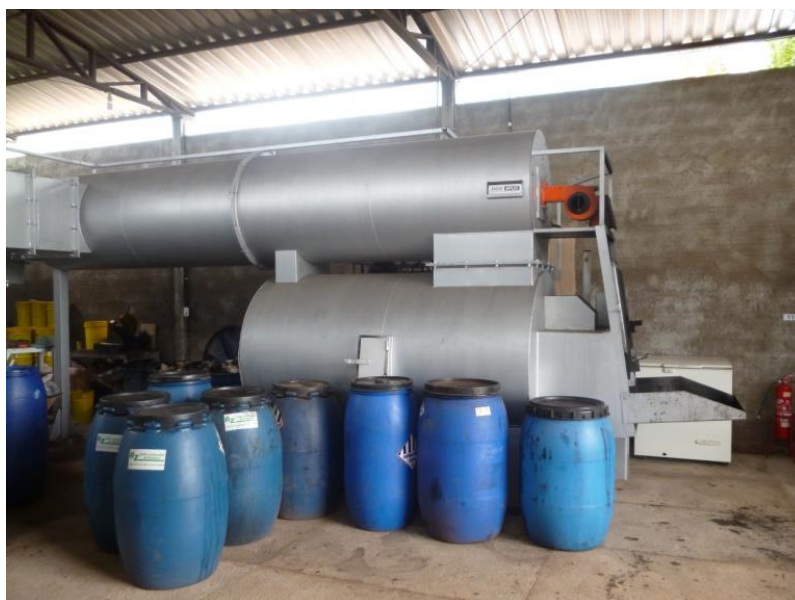
Figura 156 - Incinerador utilizado queima dos RSS.
