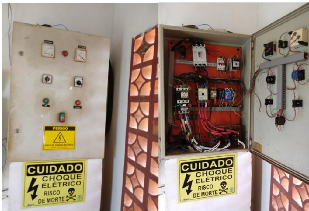
Figura 64 - Vista externa do painel de comando e vista interna do painel de comando.
