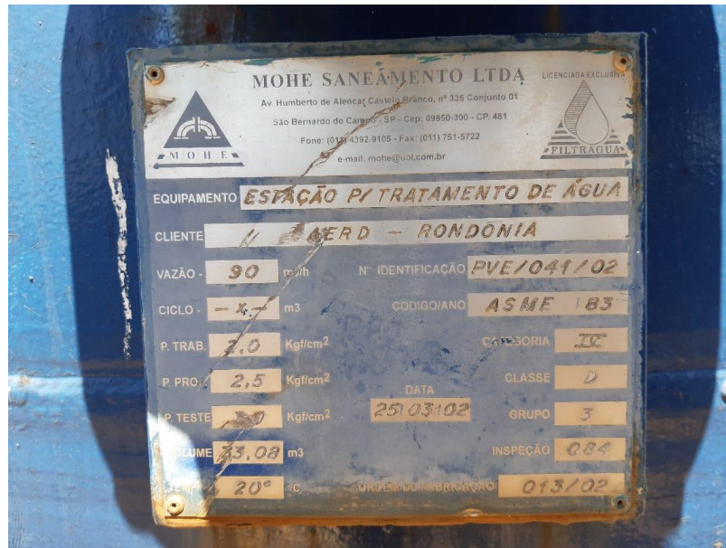
Figura 50 – Placa de identificação da ETA.
