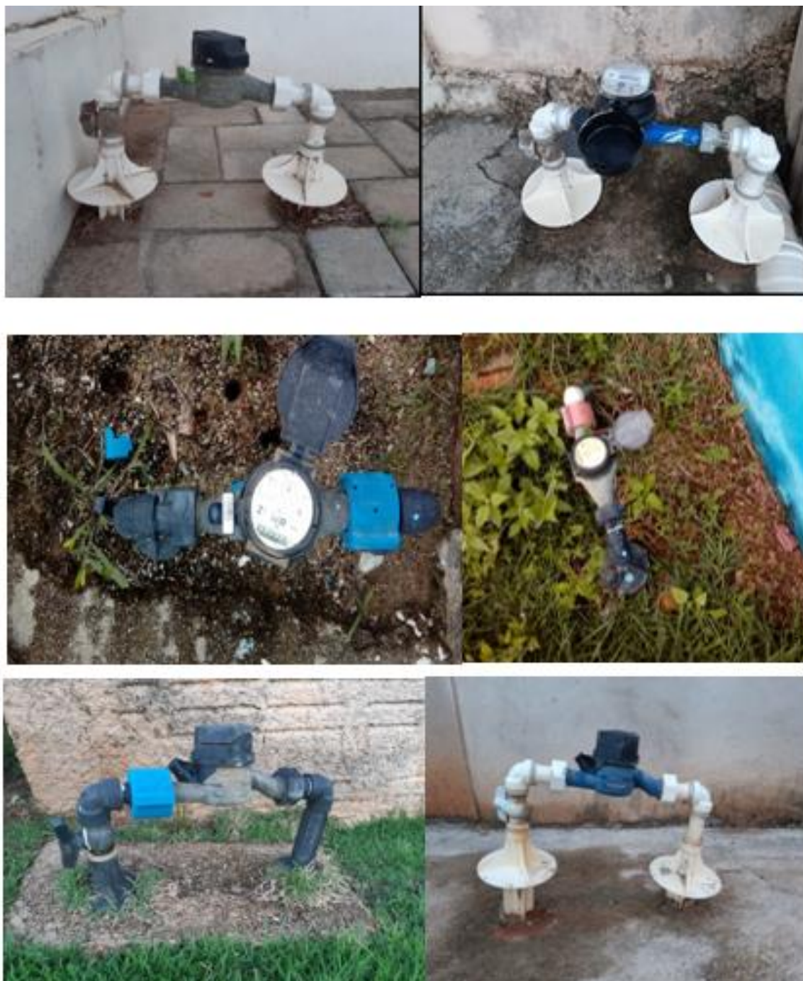
Figura 69 – Cavaletes com hidrômetros
