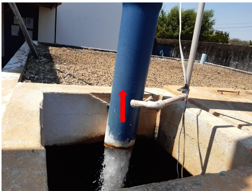
Figura 57 — Processo de adição de cloro
