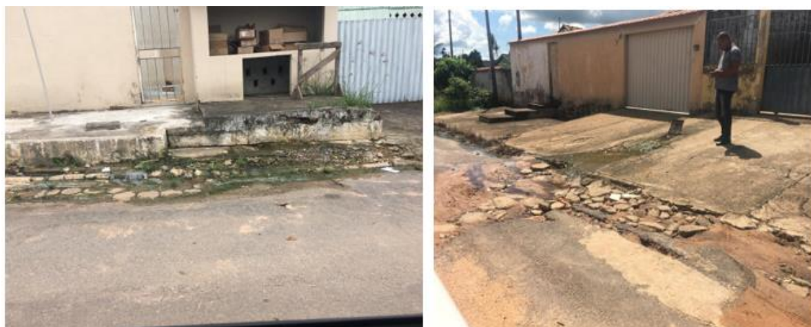
Figura 98 - Extravasamento de fossas na sede.
